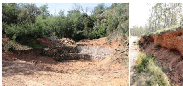
Zone d'érosion et ouvrage de protection.
